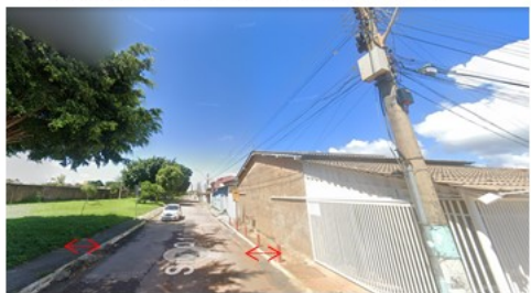
Figura D: Dimensionamento de calçada inadequado
