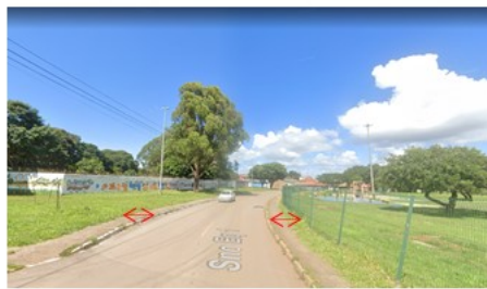
Figura E: Dimensionamento de calçada inadequado
