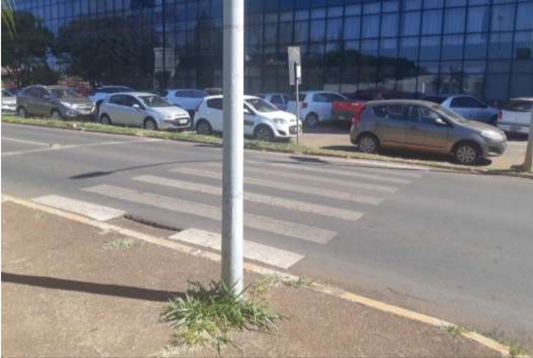
Figura 43: Travessia sem rampas e continuidade nos passeios na via W4 Sul. Fonte: AGC Projeto e Planejamento.
