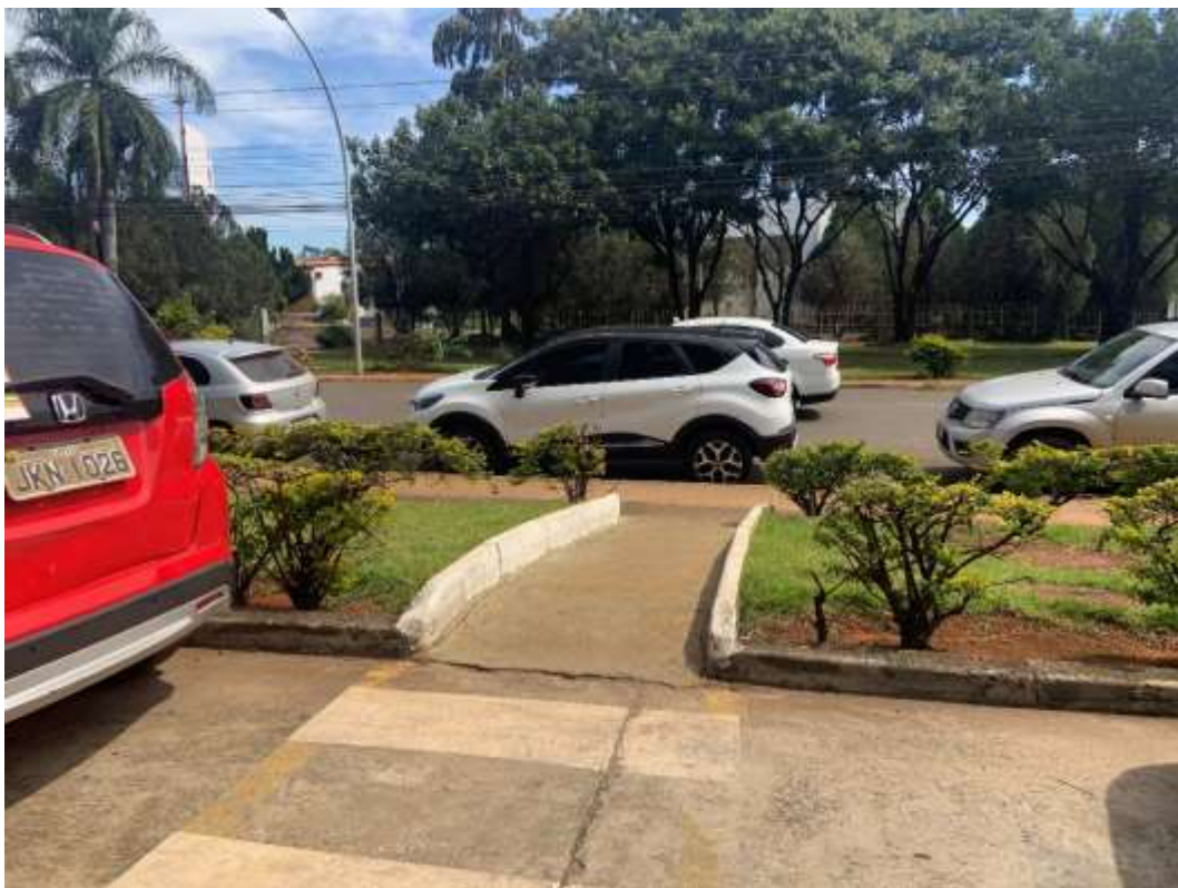
Figura 14: Rampa de acesso na via W5 Sul fora de padrões de acessibilidade. Fonte: AGC Projeto e Planejamento.
