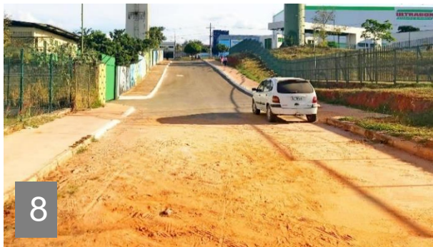
Fig. 8: Acúmulo de Resíduos no final da pista.
