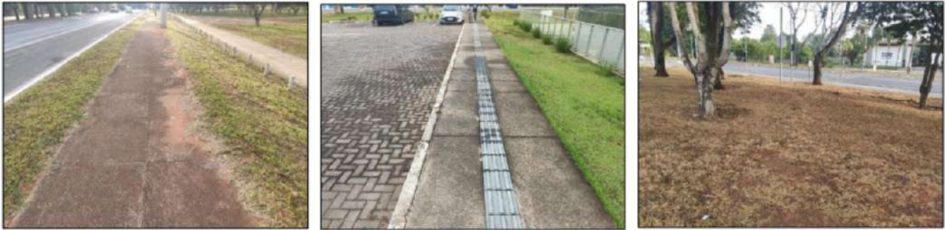
Figura 02: Calçadas ao longo da EPDB; calçadas em frente ao empreendimento; e trecho do canteiro central sem calçamento e acessibilidade. Fonte: Estudo Técnico de Impacto de Vizinhança 91 - 120 (124103867), página 118
