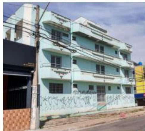
Figura 18: Fachada lateral fotografada em vstoria tcnica. Fonte: Vstoria Tcnica de 18/5/2021.
