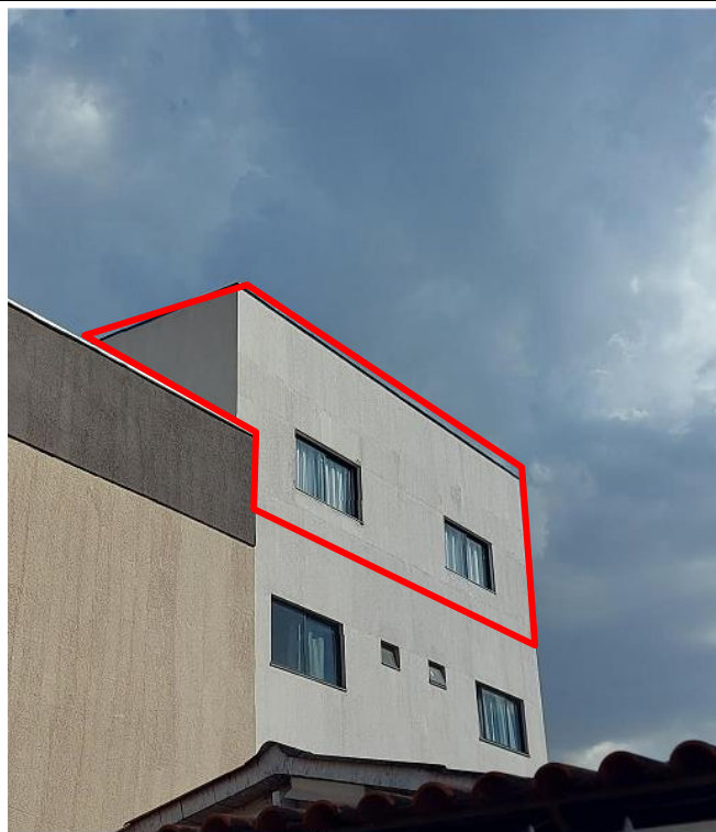
Imagem 6 – Vista do fundo da edificação, área coberta no 4º pavimento e não licenciada
