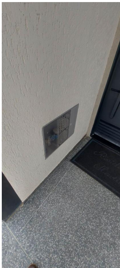
Imagem 9 – Hidrômetro no hall de entrada (onde seria o depósito, no projeto licenciado)
