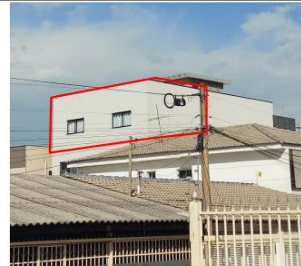
Imagem 7 - Vista do fundo (outro ângulo) da edificação, área coberta no 4º pavimento e não licenciada
