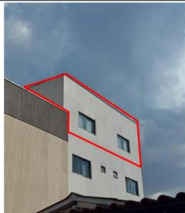
Imagem 6 – Vista do fundo da edificação, área coberta no 4º pavimento e não licenciada
