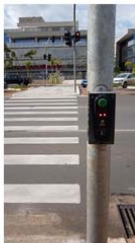
Figura 68: Semáforo sonorizado executado pelo empreendedor.
