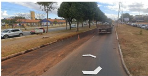
Figura E: Via alagados sentido Santa Maria
